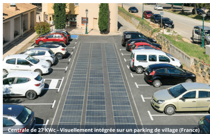
Centrale de 27 kWc - Visuellement intégrée sur un parking de village (France)
